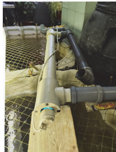
е) система трубопроводов и УФ обеззараживание
