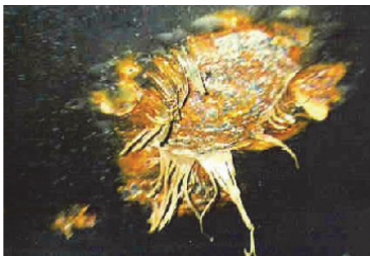
Рис. 3. Коррозия в зоне вмятины от удара Fig. 3. The impact dent area corrosion
