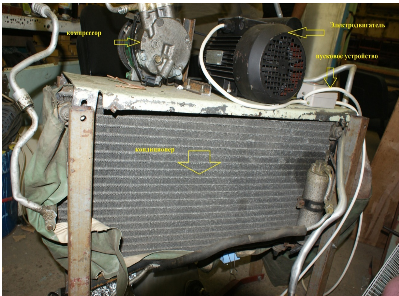
Рис. 4. Вид со стороны конденсатора
